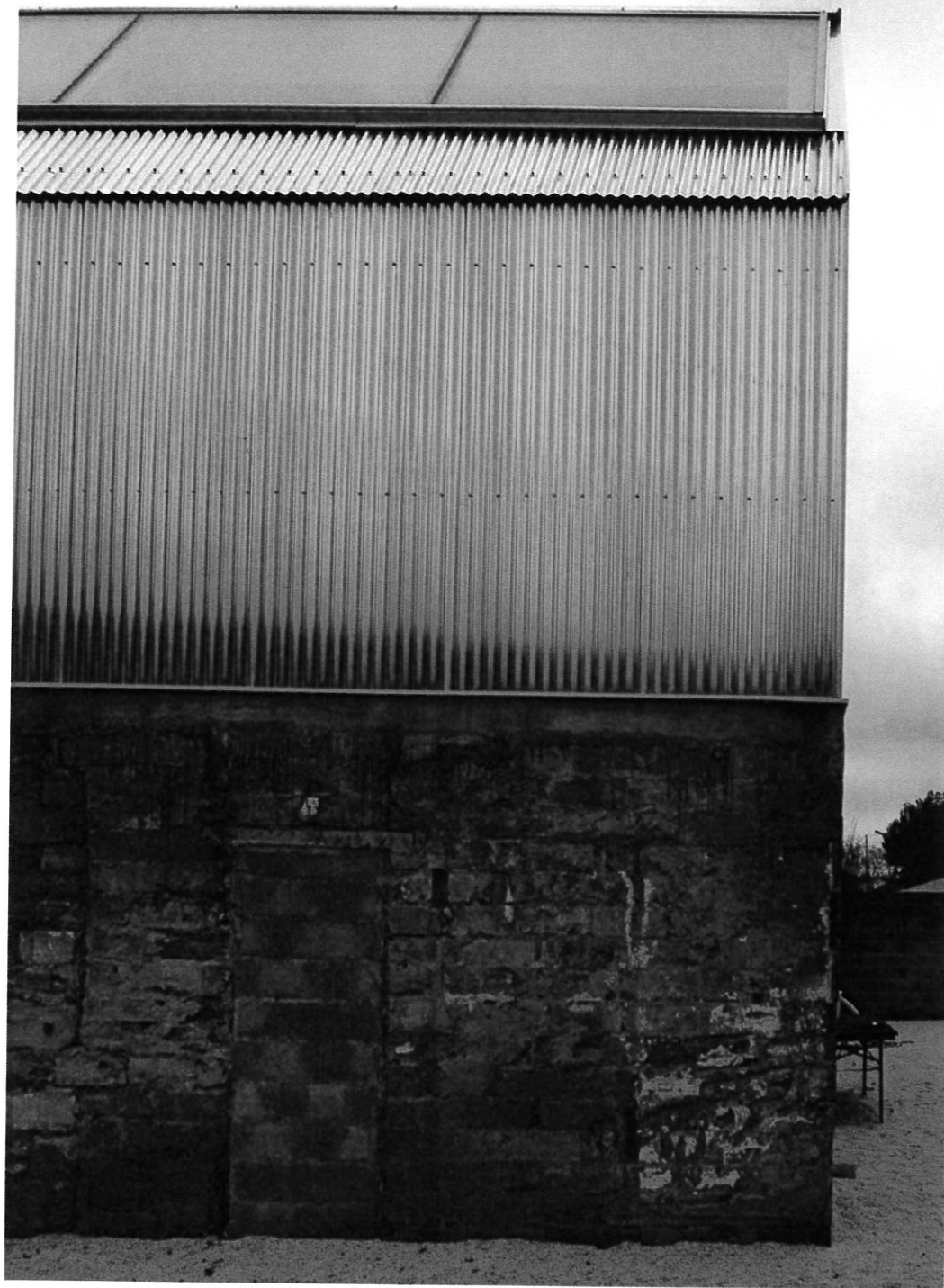
↑ Reconversion d'un ancien garage en habitation (Mur parpaing existant et tôle ondulée galvanisée) - BAST architecte
